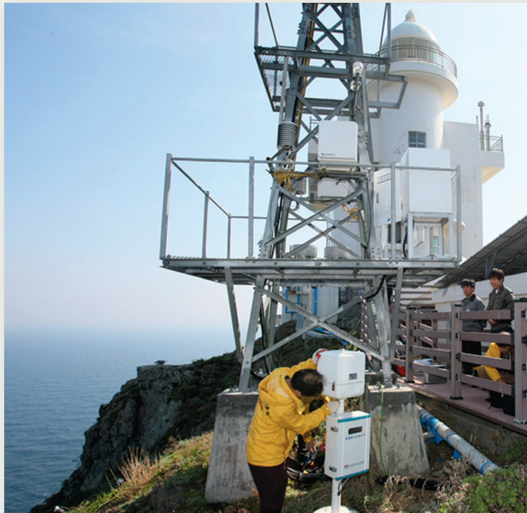
▲ 독도에 설치된 등대와 방사능 감지기
